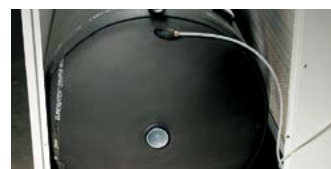
Serbatoio di accumulo ad alta capacità.
